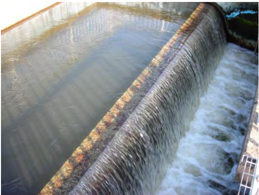
浄水場着水井(原水:浄水場入口)
